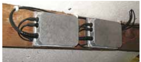
Fig.2. Omvormers in de zolderruimte achter de panelen buiten. Ze worden wat warm bij zonne-instraling en leveren stroom terug aan het net door met een hoge frequentie korte stroompulsen van hogere spanning in de netspanning te injecteren.
