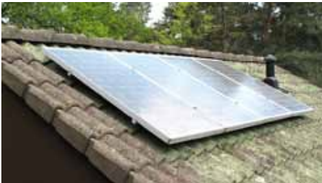
Fig.1. Vier zonnepanelen van elk een halve vierkante meter zijn gekoppeld in twee units. Aansluitingen gaan onder de dakpannen naar de zolderruimte.
